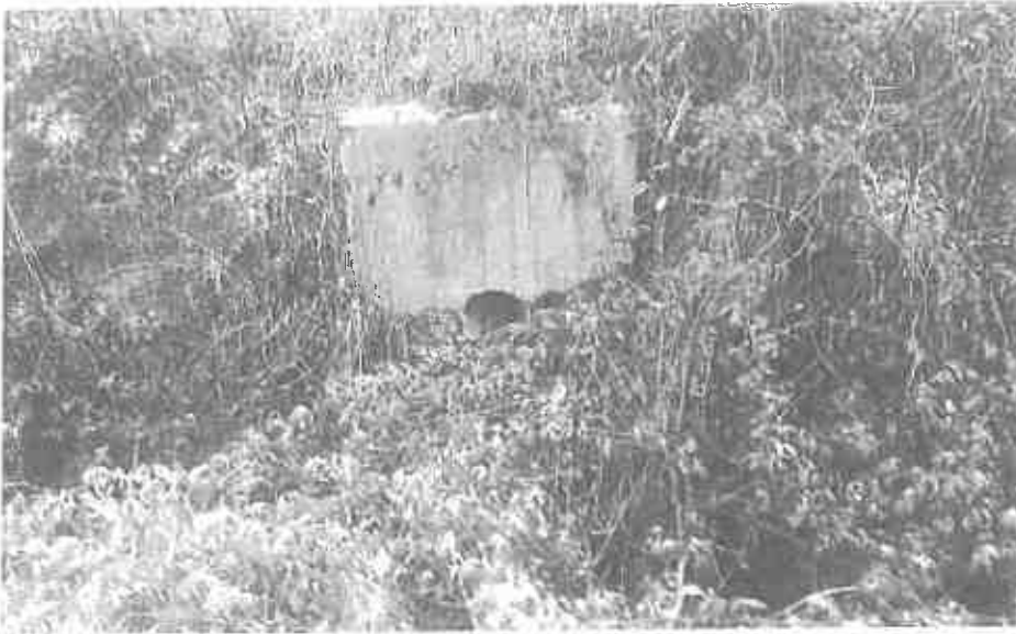
Photo 4 : le ruisseau des Moulins à nouveau en surface le long du par 2 du golfe de L'Isle d'Abeau
