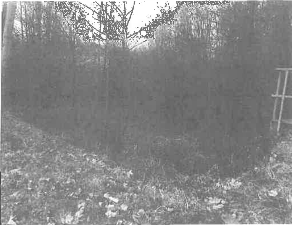
Photo 1 : Bassin de rétention sur le Galoubier (angle rue de Presle et rue de la commanderie) Vision de l'atterrissement rendant inopérante la fonction du bassin
